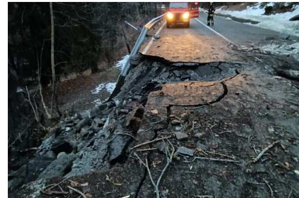
Figura 93 Evento franoso sulla SS.26
